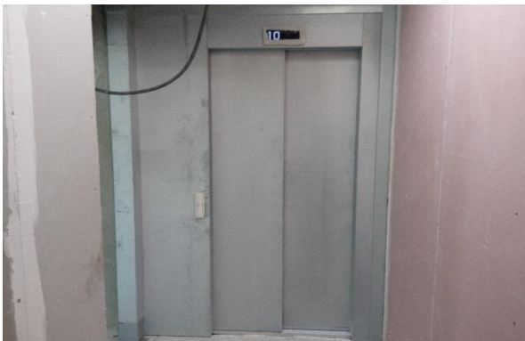
Ascenseur en fonctionnement.
