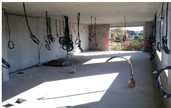
Passage des réseaux techniques
